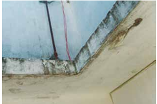
Teto com mofo
