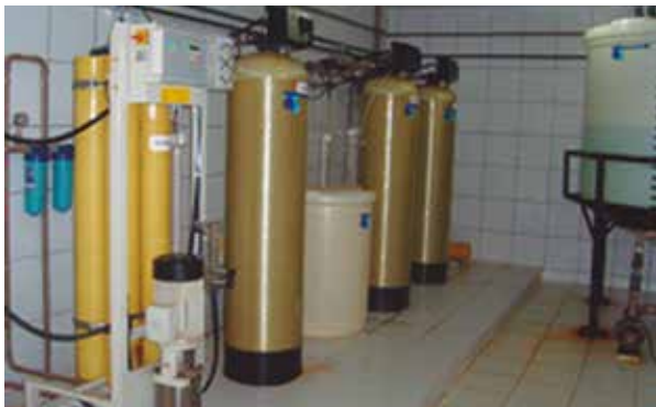
Filtração e fornecimento de água sem aferição
