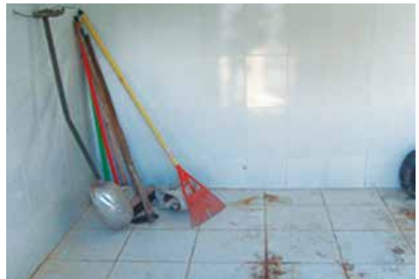
Câmara de resíduos suja
